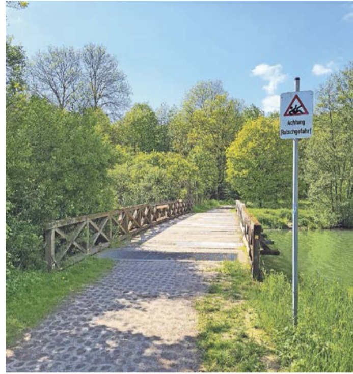
Nach über 30 Jahren Belastung, Witterung und Einstauereignissen ist die Substanz der vorhandenen Brücken in die Jahre gekommen. (Foto: privat)
